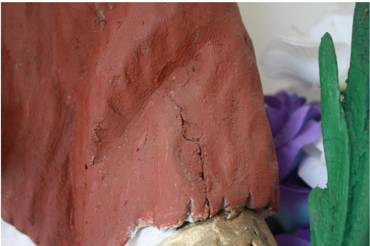
Fot. 7. Hladovka, Slovensko. Domčeková kaplnka s drevenou sochou Jána Nepomuckého, pohľad na detail sochy. Viditeľné praskliny v dreve a malte. Fot. M. Książek 2016
