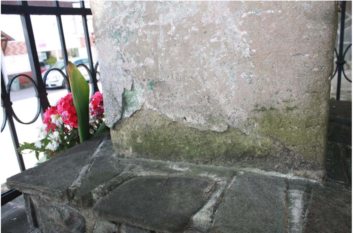
Fot. 5. Pohľad na dolnú časť sokla, kde vidieť poškodenia mikrobiologické, v podobe lišajníkov a machu. Kameň je degradovaný a uvoľnený. Fot. M. Książek, 2016
